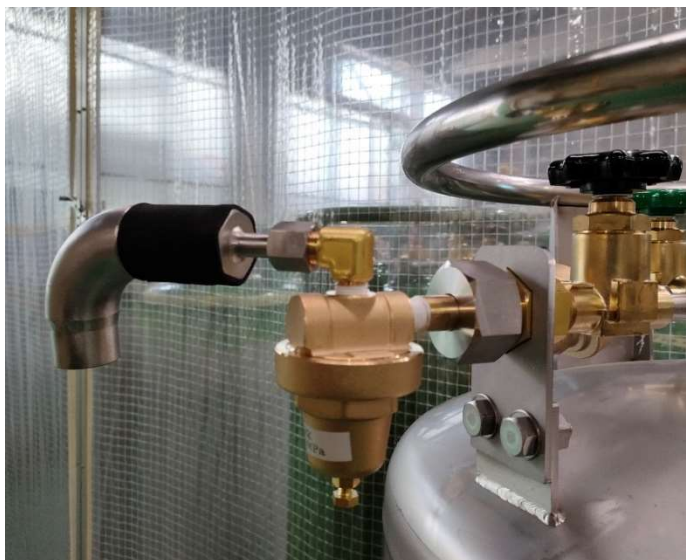
リリーフ弁+サイレンサー取付け写真
